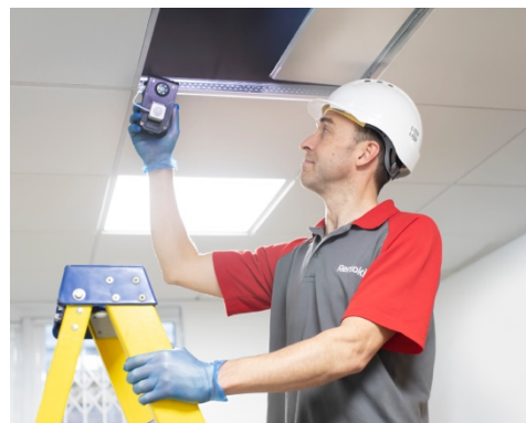
OPTIX ermöglicht die Überwachung schwer zugänglicher Bereiche, zum Beispiel abgehängte Decken. © Rentokil Initial
