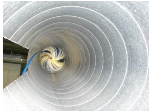
Raumlufttechnische Anlagen können signifikante Auswirkungen auf die Gesundheit und das Wohlbefinden haben. © Rentokil Initial
