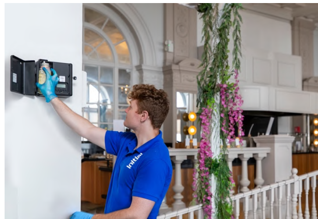
Ein Initial Servicemitarbeiter prüft das installierte Duftsysteem und stellt die passende Anwendung für den jeweiligen Raum sicher. © Rentokil Initial
